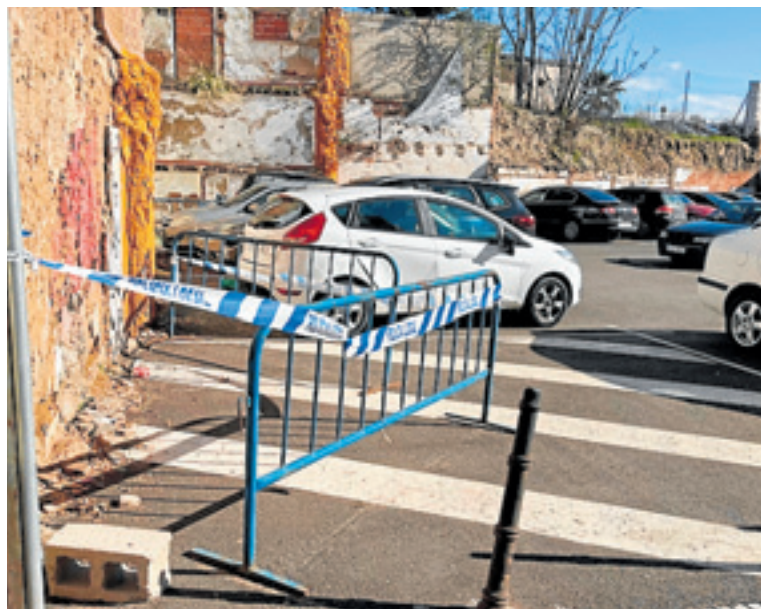
La zona donde hay desprendimientos. HOY
