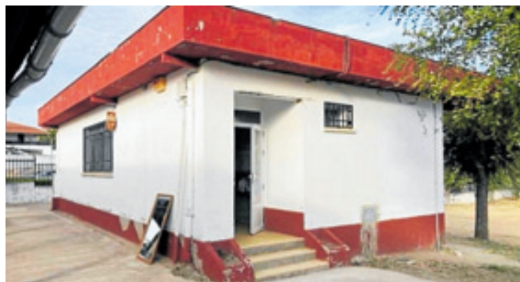
Acceso al edificio de educación infantil, que carece de rampa. A. S.
