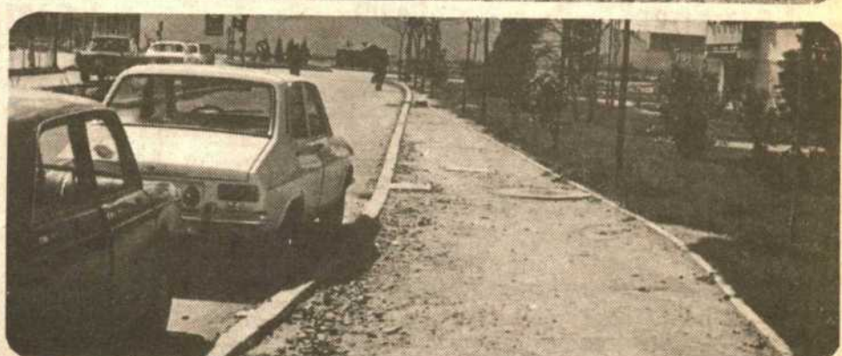
La calzada de servicio del Polígono de La Paz fue modificada por el Plan Redia. El espacio para peatones, acera sin pavimentar, sufrió las consecuencias. También aquí hay que circular por la calzada. Quizás le toque al I.N.U.R. subsanar la deficiencia. — (Foto Emilio.)
