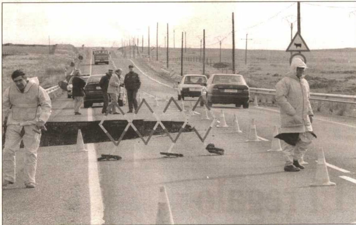
El agua arrancó un trozo de la N-521 el pasado 6 de noviembre, día al que corresponde la foto. / Foto: CORDERO
