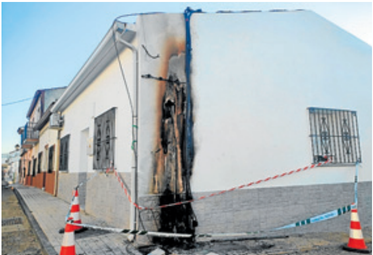
Tendido eléctrico incendiado. F.N.
