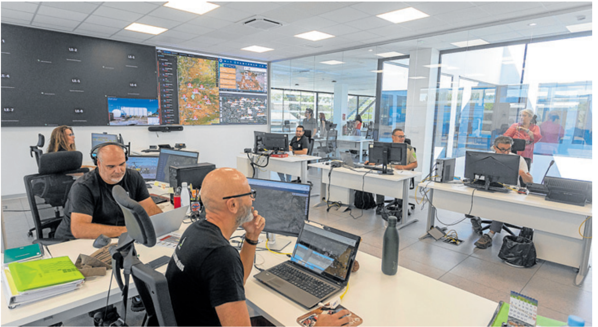
Sala de control del nuevo COR del Infoex, centro neurálgico de la lucha contra los incendios en la región. JORGE REY
