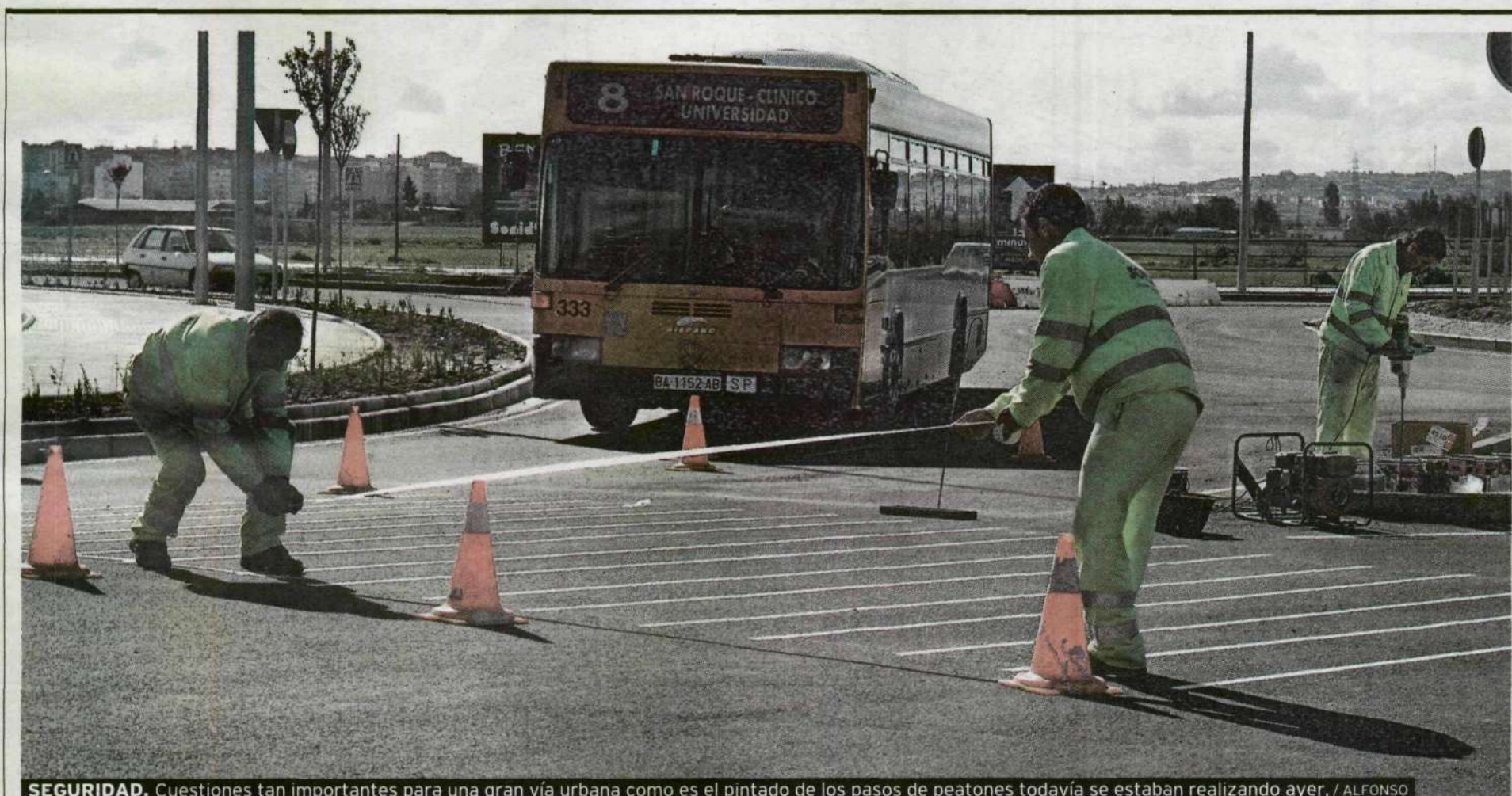
SEGURIDAD. Cuestiones tan importantes para una gran vía urbana como es el pintado de los pasos de peatones todavía se estaban realizando ayer. / ALFONSO
