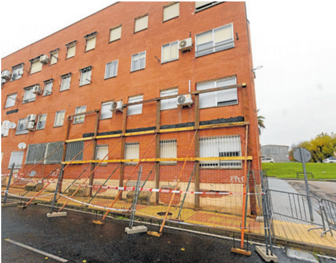
El edificio de la calle Río Tiber está actualmente apuntalado. JORGE REY
