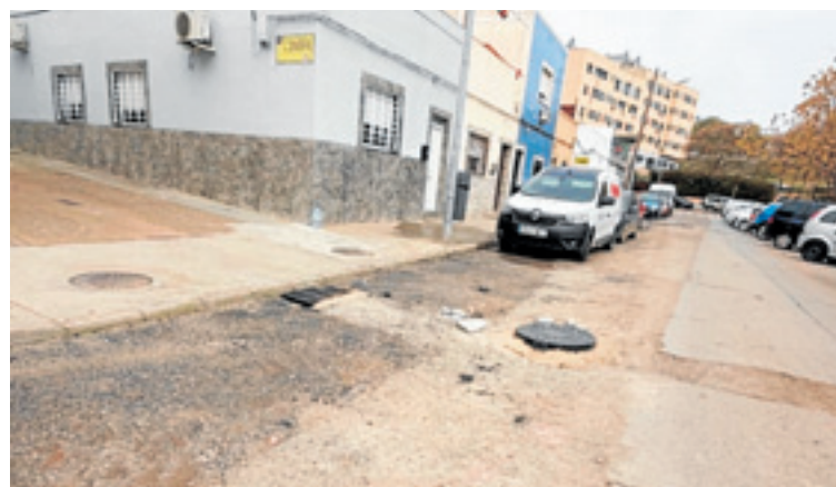
Estado en el que se encuentra la calle Coimbra. HOY
